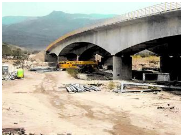
Gráfica 4. Avances de la Construcción del Puente Tienditas / 13 de octubre 2015. Fuente. Imagen tomada del Archivo / Periódico Portafolio, 13 de octubre de 2015.
