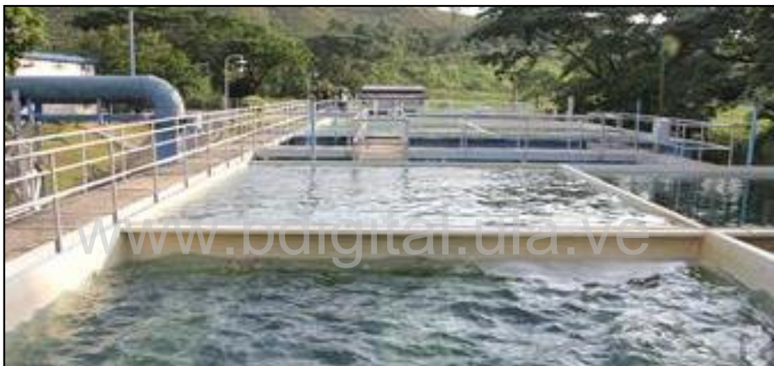
Figura 16. Planta de potabilización de agua El Vigía. Imagen extraída de la dirección web: http://www.aguasdemerida.com.ve/
