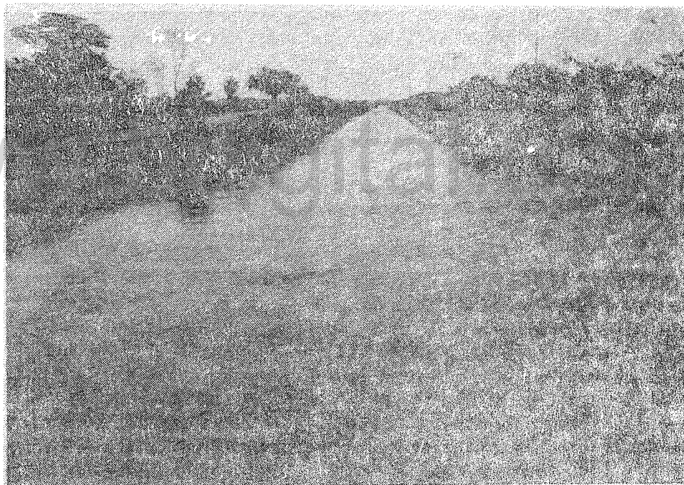
Figura 12. Inicio del canal principal.
