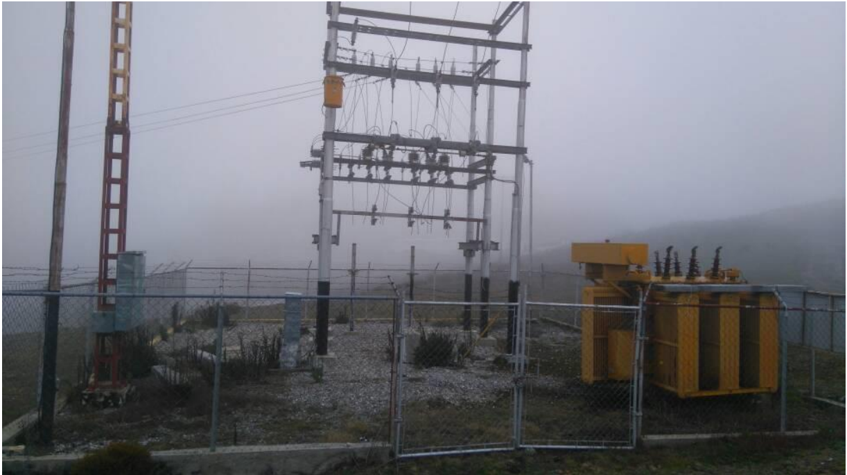
Figura A. 3 Vista de frente S/E El Águila
