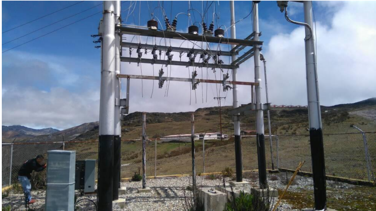
Figura 3.1 Pórtico S/E El Águila
