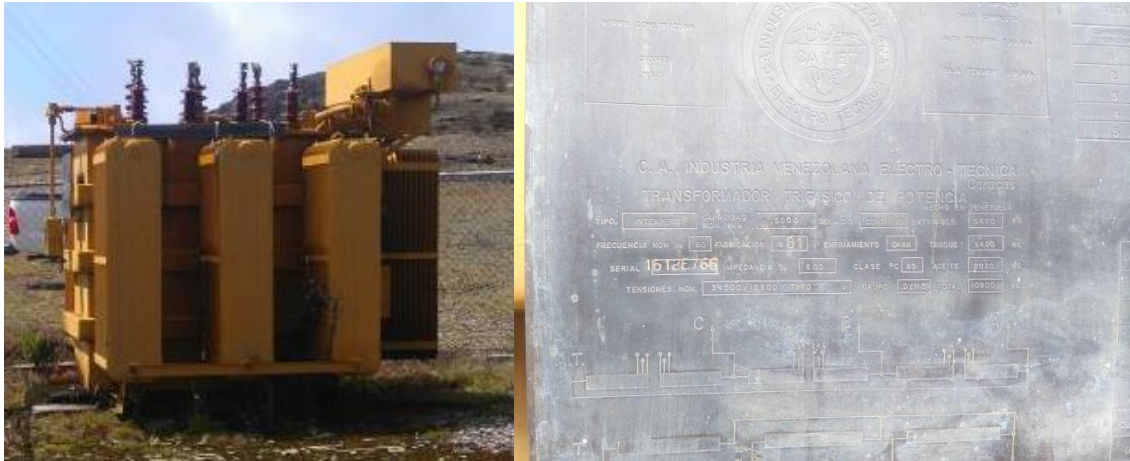
Figura 4.1 Transformador de potencia S/E El Águila
