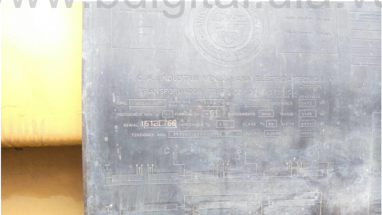
Figura A. 2 Datos de placa transformador de potencia actual (Dañado)
