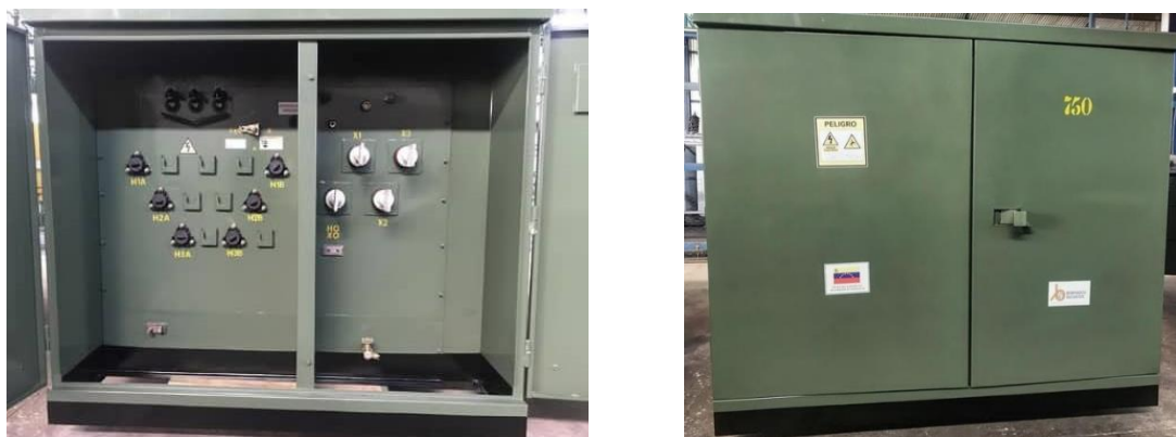
Figura 2.9 Transformador tipo Pad Mouted.
