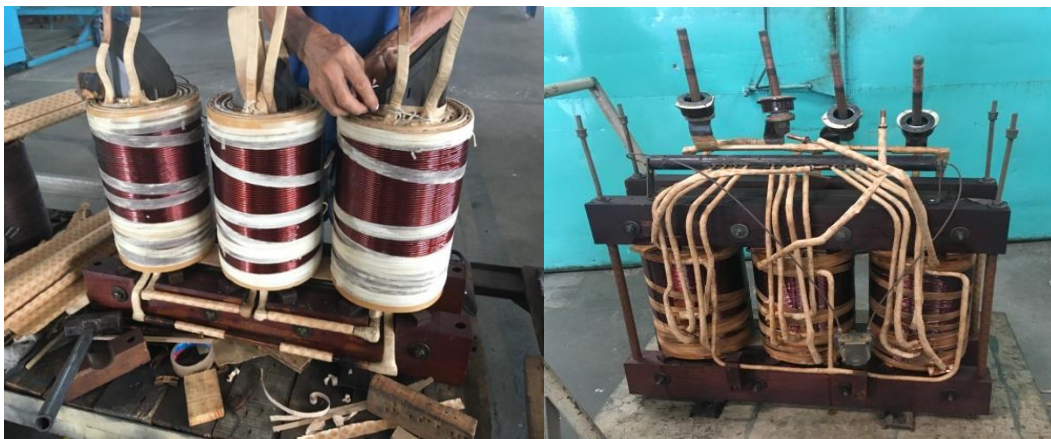
Figura 4.12 Visualización del proceso de armado de parte activa.
