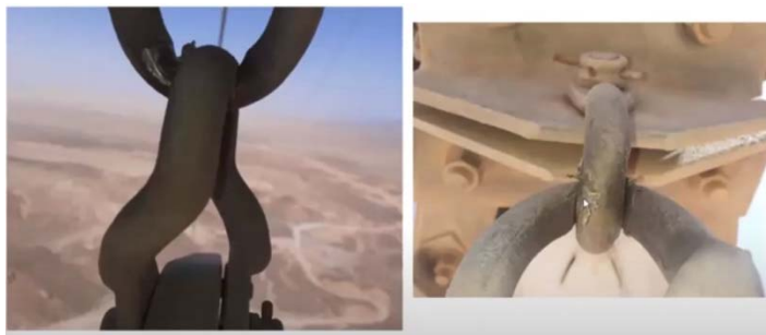
Fig. 3.18 Corrosión de estos elementos a causa del efecto corona en una línea a punto de colapsar [10].
