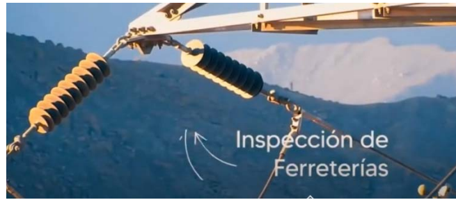
Fig. 5.3 Imagen aérea tomada con un dron para verificar las condiciones de los herrajes y la estructura [10].
