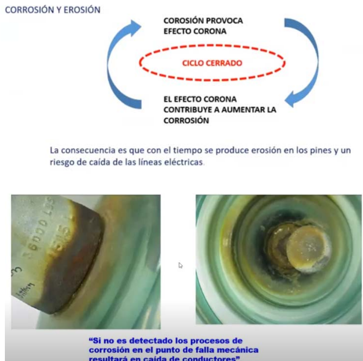
Fig. 3.12 Corrosión por efecto corona en conexiones de las cadenas de aisladores [10].
