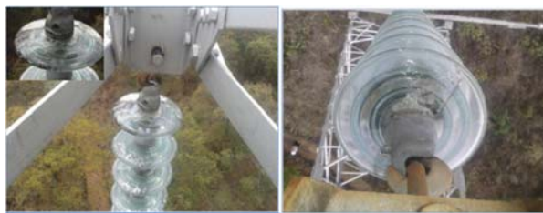
Fig. 5.27 Cadena de aislamiento flameada [12].
