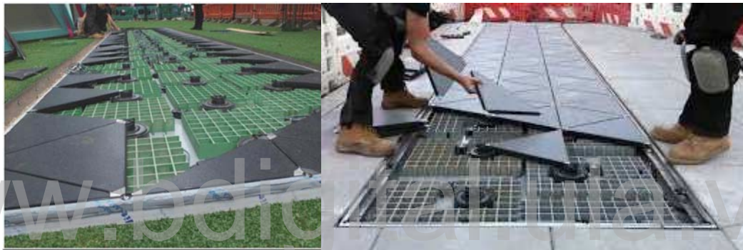
Figura 4.8. Instalaciones de Módulos de Baldosas PAVEGEN.
