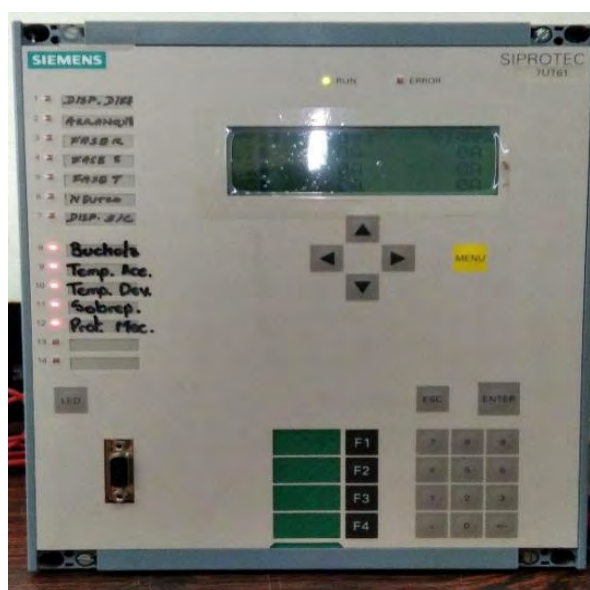
Figura 5.26: Señalización del relé 7UT613 ante disparos de las protecciones mecánicas del transformador.
