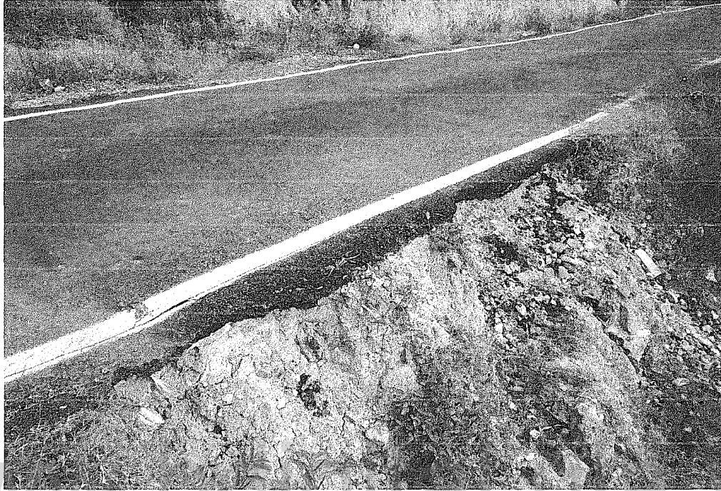
Deterioro de las vías entre el sector el Rodeo y la Urb. Andrés Bello
