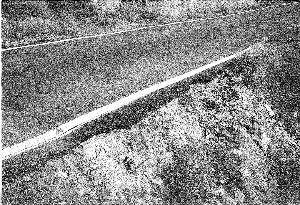
Deterioro de las vías entre el sector el Rodeo y la Urb. Andrés Bello
