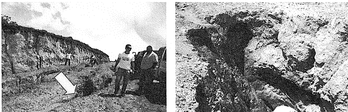
Figura 20 Vía de acceso a la comunidad La Loma de los Colmenares. En las imágenes pueden observarse los procesos de erosión y deforestación en esta carretera. La imagen de la derecha muestra un acercamiento de los procesos mencionados.
