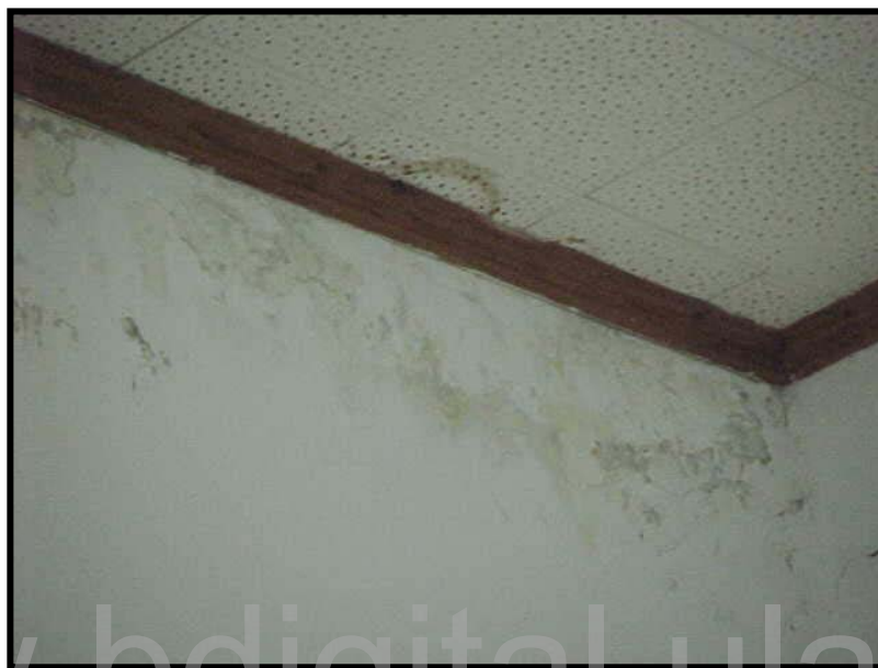
Foto N° 8. Techo de la Clínica de Periodoncia, el mismo es de asbesto, material contaminante, presenta filtraciones de agua que han alcanzado la pared causando un daño evidente, lo cual provoca presencia de hongos y polvillo en el ambiente.
