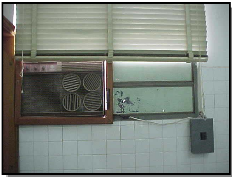
Foto N° 13. Sala Clínica de Periodoncia. Persianas inadecuadas, aparato de aire acondicionado e interruptor eléctrico instalados inapropiadamente.
