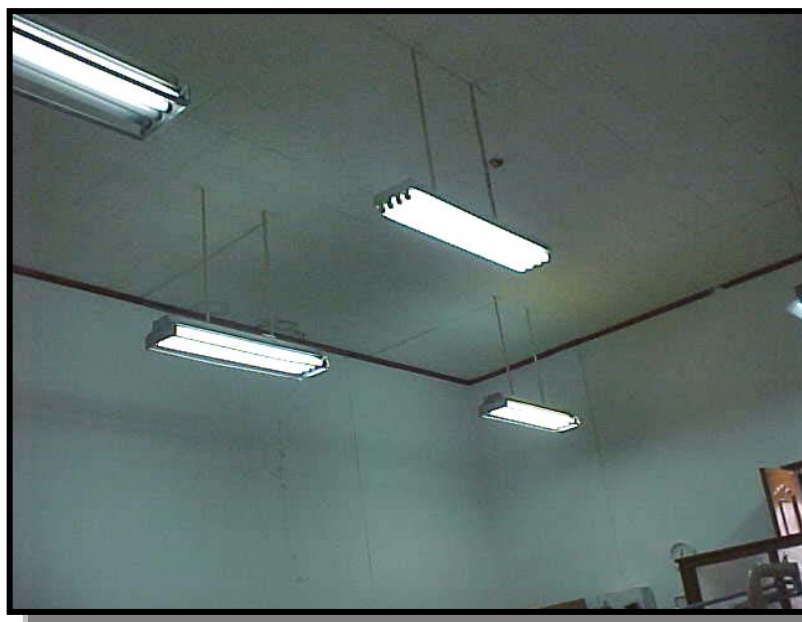
Foto N° 9. Clínica de Periodoncia. Iluminación deficiente.
