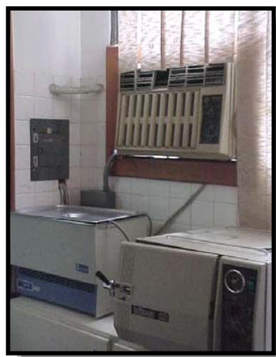
Foto N° 12. Clínica de Periodoncia. Sala de Quirófano, el aire acondicionado está próximo a persianas que retienen polvo y a los aparatos de esterilización.
