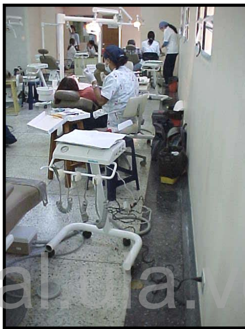
Foto N° 6: Sala Clínica de Integral del Adulto. Toma corriente mal ubicado, cableado por el piso junto a maletines.
