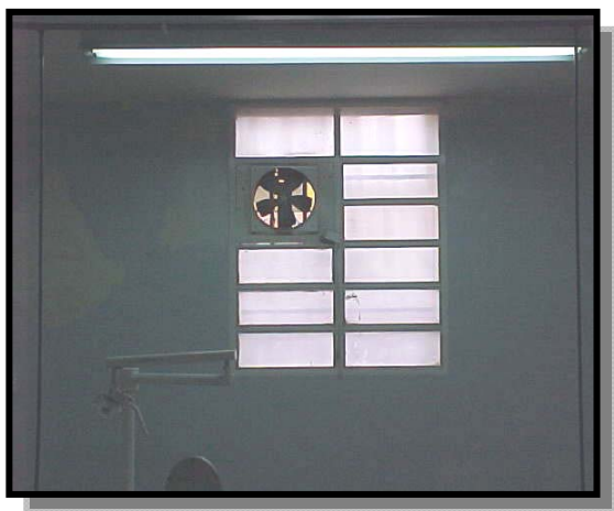
Foto N° 5: Sala Clínica de Operatoria. Ventilación forzada hacia la calle.
