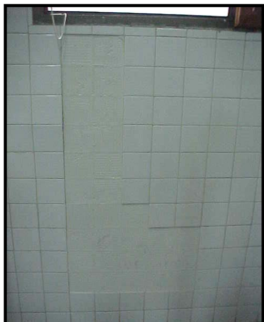
Foto. N° 2: Sala Clínica de Periodoncia. Paredes recubiertas de baldosas que se encuentran en mal estado.
