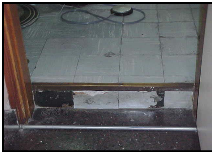
Fig N° 11. Clínica de Periodoncia. Entrada al quirófano. Piso deteriorado y ubicación riesgosa de la tubería de agua potable.
