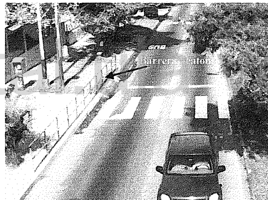
Figura 35: Paso peatonal que presenta discontinuidad del acceso por presencia de barrera.
