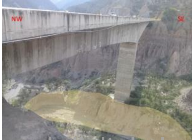
Figura 47. Socavación de estribos en puentes de la Troncal 007, Las González – Estanques.
