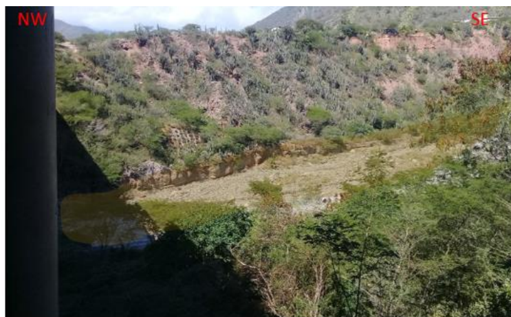
Figura 55. Socavación, acumulación de sedimentos.
