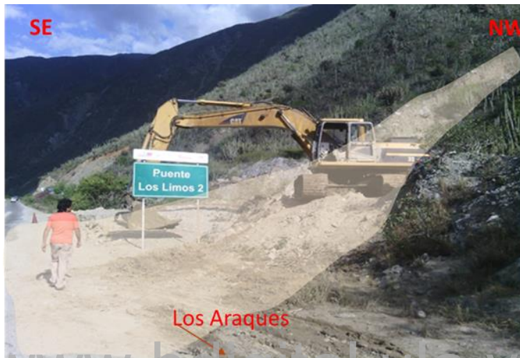
Figura 14. Afectación vial, por flujo de detritos en el puente Los Limos 2.
