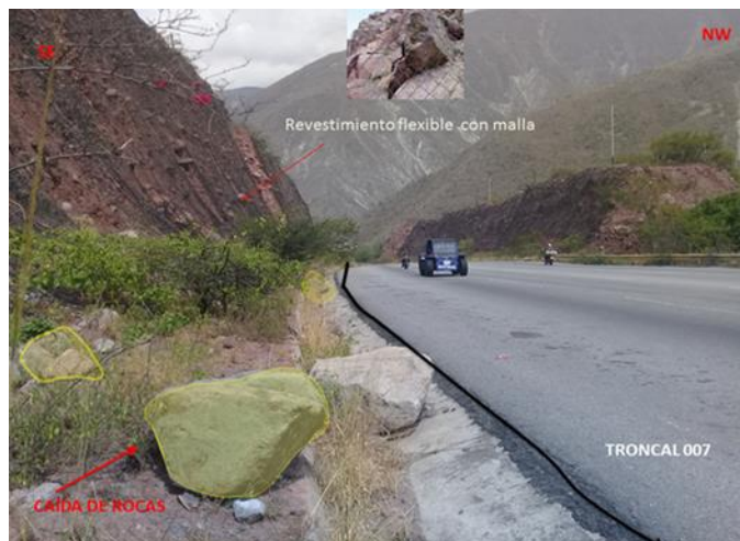
Figura 19. Caída de rocas en depósitos cuaternarios de la Troncal 007, Las González- Estanques.
