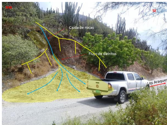
Figura 15. Afectación vial, por flujo de detritos, entrada al sector Los Araques
