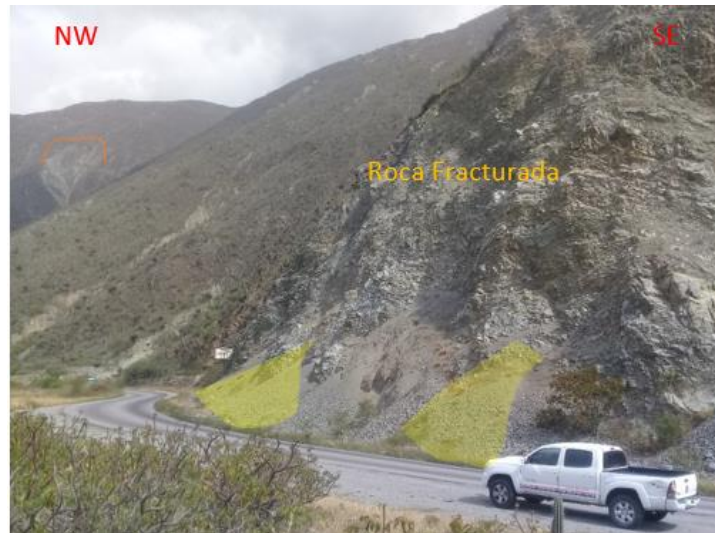
Figura 54 Asociación Tostós (cuarcita), con evidencia de caída de rocas y conos de detritos que generan problemas de transitabilidad en la Troncal 007, Sector Los Araques.
