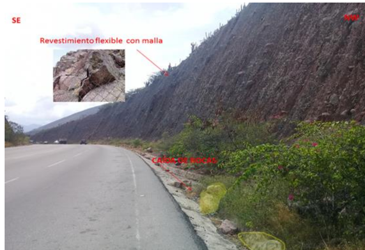
Figura 20. Caída de rocas en depósitos cuaternarios de la Troncal 007, Las González- Estanques.
