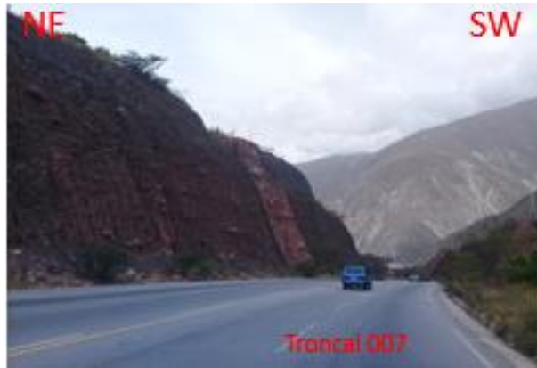
Figura 45. Escarpes erosivos en la Troncal 007 Las González a Estanques.
