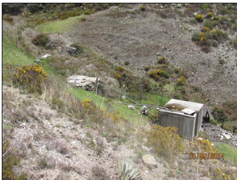
Figura 31. Toma de agua en la comunidad de Peñas Coloradas, Municipio Rangel del estado Mérida
