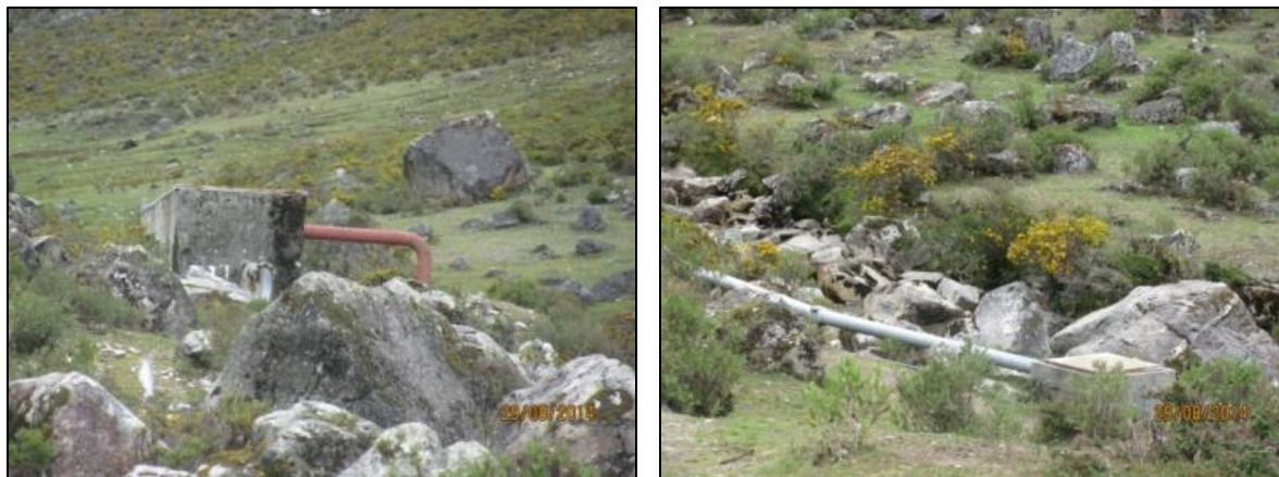
Figura 30. Toma de agua en Mifafí, Municipio Rangel del estado Mérida.
