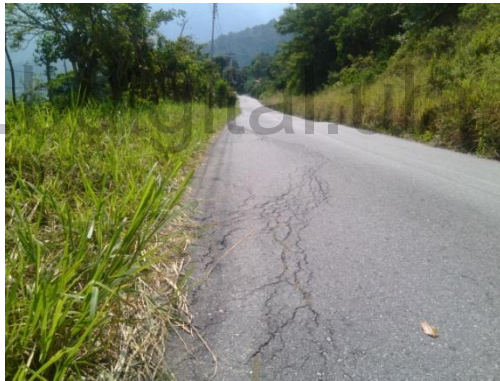
Figura 41. Progresiva 6+450. Falla de borde.
