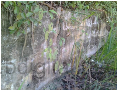
Figura 39. Progresiva 4+650. Grieta en pantalla de muro armado.
