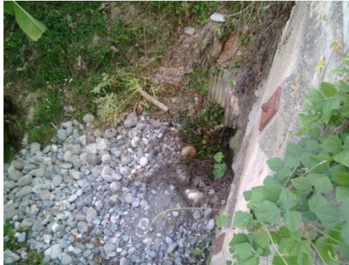
Figura 50. Progresiva 16+220. Condiciones de la boca de salida de alcantarilla
