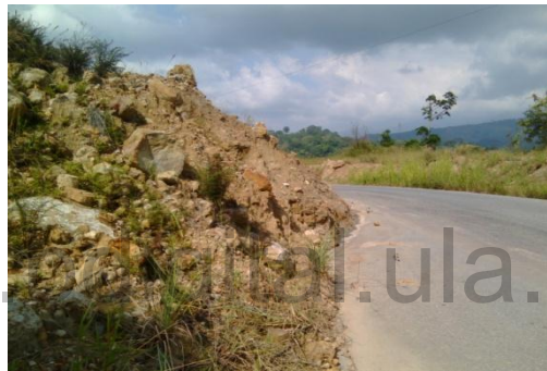
Figura 55. Progresiva 23+780 material sedimentario desprendido interrumpiendo la calzada.
