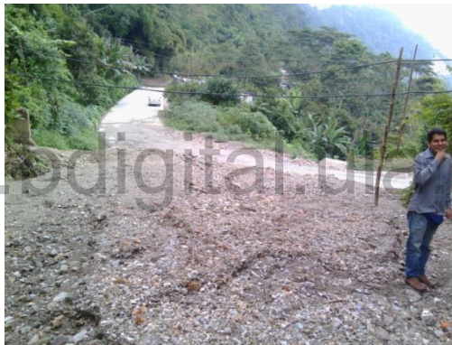
Figura 46. Progresiva 10+460. Quebrada La Granzonera. Interrupción del 60% de la calzada por material fino aportado por la misma.
