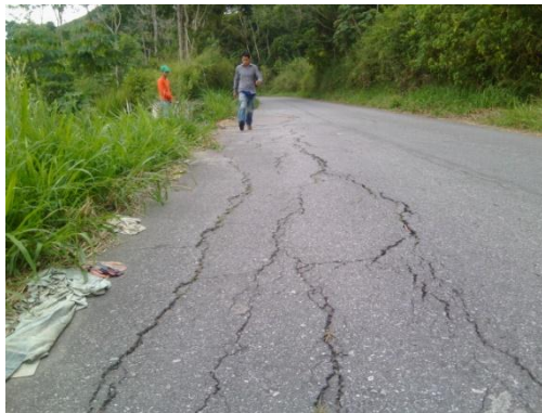
Figura 42. Progresiva 9+000 Falla de borde. Deformación de calzada.
