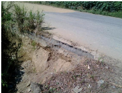
Figura 37. Progresiva 1+950. Falla de borde interno de la curva. Ausencia de cunetas o canales.
