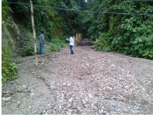
Figura 45. Progresiva 10+460. Quebrada La Granzonera. Aporte de detritos. Colmatación de torrenteras.
