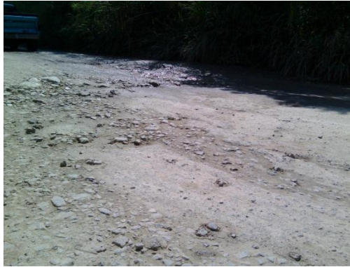
Figura 38. Progresiva 4+400. Afectación de la estructura de pavimento. Presencia de humedad.
