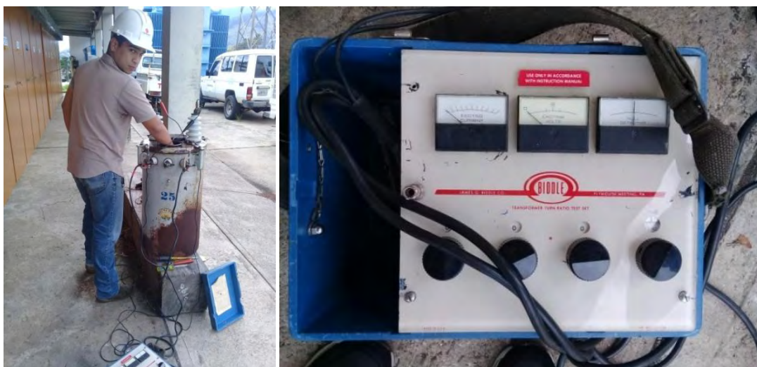
Figura 4.6 Equipo, conexión y medición de la relación de transformación para el transformador en estudio.
