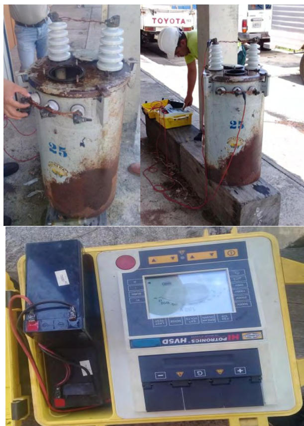
Figura 4.4 Equipo, conexión y medición de la resistencia de aislamiento para el transformador en estudio.
