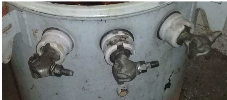
Figura 4.2 Bushing de baja tensión anteriores del transformador en estudio.
