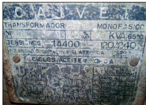
Figura 4.1 Placa de datos del transformador en estudio.
