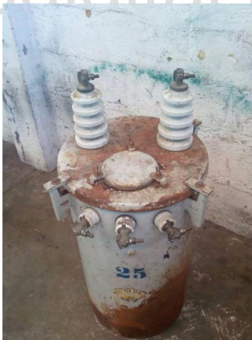
Figura 4.3 Estado de la cuba del transformador en estudio.
