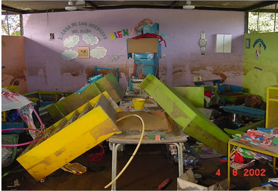
Imagen 4.8: Daños registrados en un aula luego de inundaciones de Guasdalito - Apure (Fuente FEDE, 2002).
