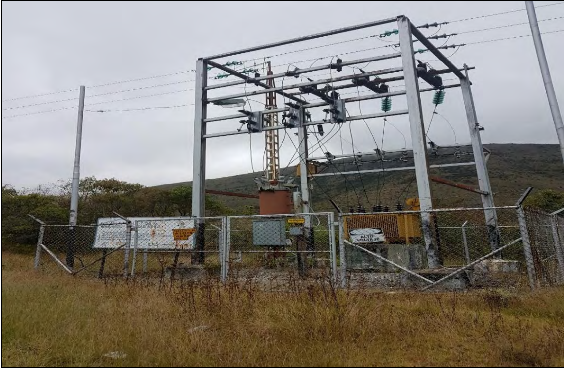
Figura 9: Subestación Los Frailes
