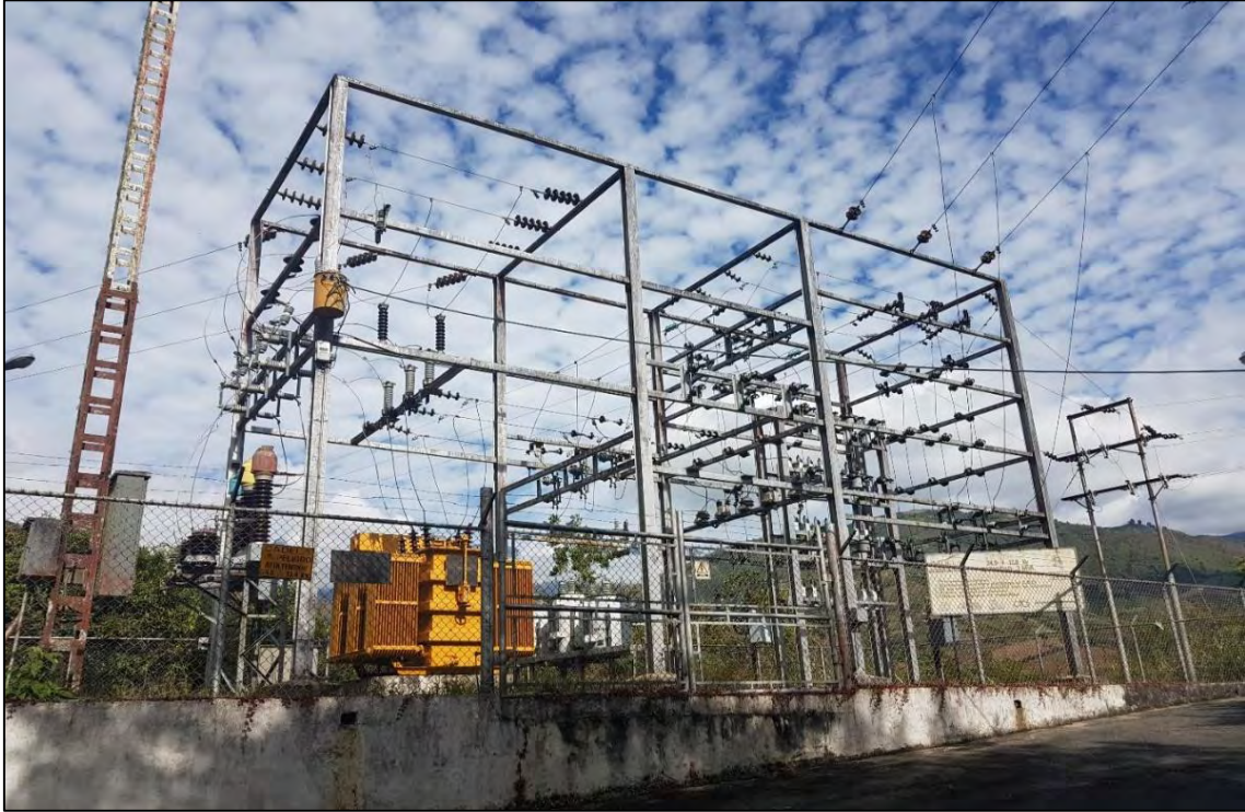
Figura 8: Subestación La Mitisus.
