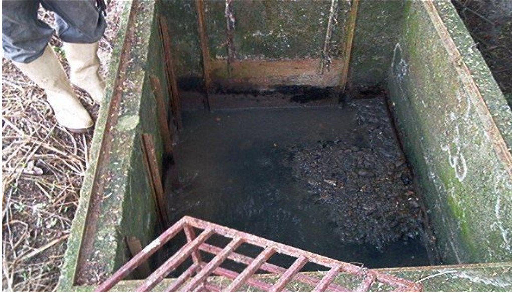
Figura 1.8 Tanquilla de entrada. Sistema de lagunas de Guayabones, municipio Obispo Ramos de Lora, Zona Panamericana, estado Mérida. Se puede observar dentro de la tanquilla material de grava que ingresa al alcantarillado por incorporación de aguas pluviales.
