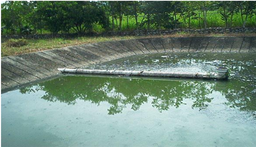
Figura 3.15. Laguna facultativa de 20 m x 30 m, implementada en Caño Seco, municipio Alberto Adriani, Zona Panamericana del estado Mérida. Observación en campo de la zona de estancamiento localizada en el extremo derecho aguas abajo.
