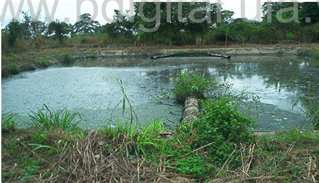
Figura 1.9 Laguna facultativa primaria, vista aguas arriba. Sistema de lagunas de Guayabones, municipio Obispo Ramos de Lora, Zona Panamericana, estado Mérida. Se observan los efectos de un desbordamiento reciente por incorporación de aguas de lluvia al sistema.
