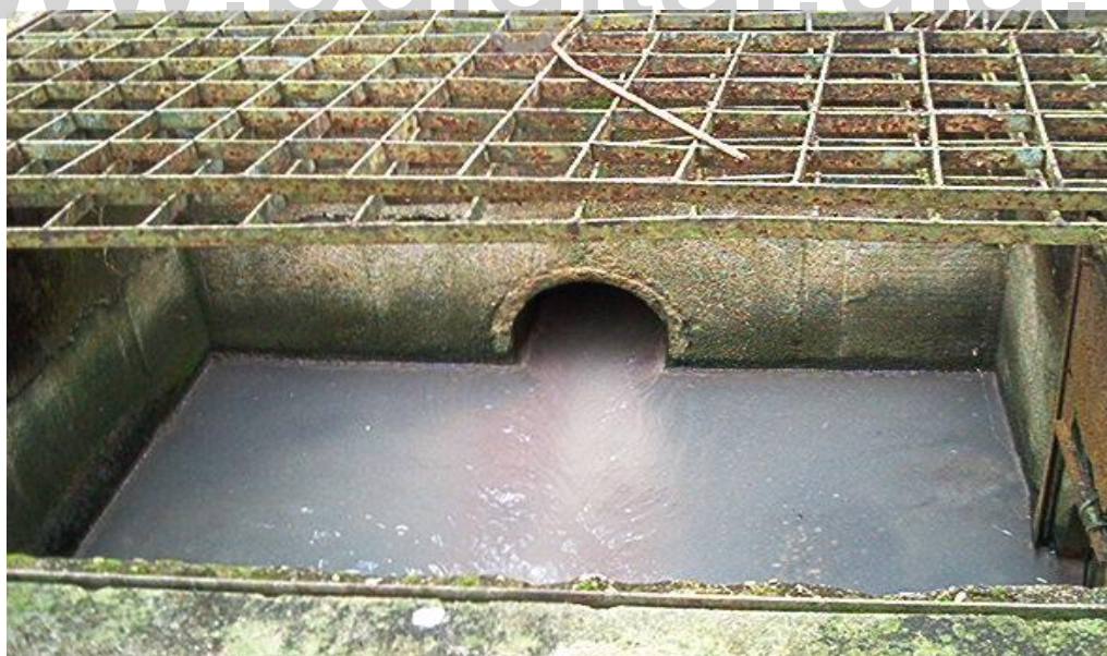
Figura 1.5 Tanquilla de entrada. Sistema de lagunas de Caño Amarillo, municipio Alberto Adriani, Zona Panamericana, estado Mérida.
