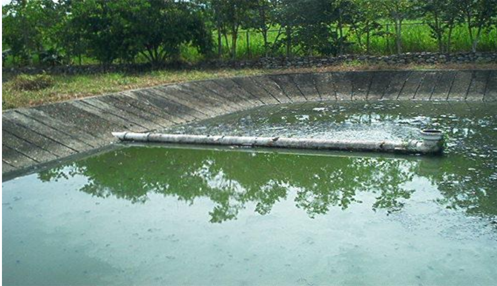
Figura 1.14 Tubería de salida de las lagunas. Sistema de lagunas de estabilización de Caño Seco, municipio Alberto Adriani, Zona Panamericana, estado Mérida.
