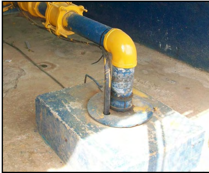
Fig. 4.13. Pozo sin orificios para poder ingresar el MicroDiver .
