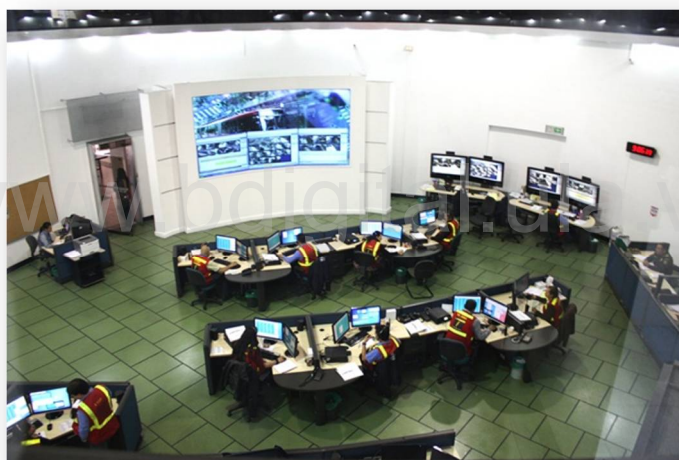
Figura 2.9. Centro de control de operaciones en Transmilenio.
