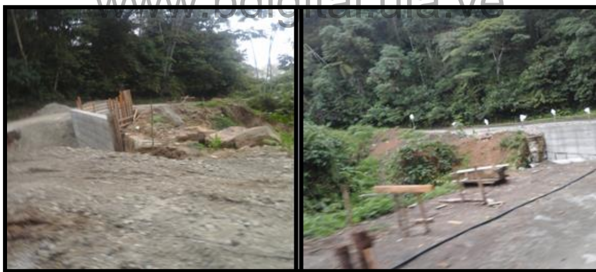
Figura 6. Deslizamiento en la vía que comunica la Azulita con la ciudad de Mérida.
