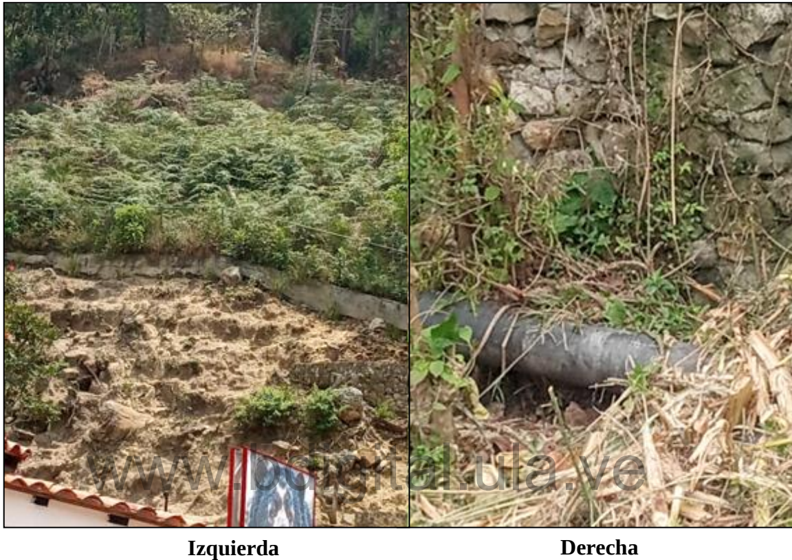
Figura 21. Obsérvese movimientos de masa que pueden afectar la tubería de agua potable (Izquierda). Figura 22. Obsérvese movimientos de masa que pueden afectar la tubería de agua potable. (Derecha) Torres (2024)
