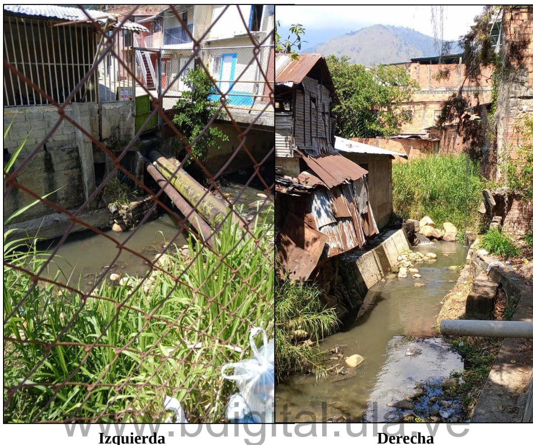
Figura 34. Se muestra la afectación de viviendas por procesos erosivos y crecida de la microcuenca Milla (Izquierda). Figura 35. Se muestra la afectación de viviendas por procesos erosivos y crecida de la microcuenca Milla (Derecha) Torres (2024)
