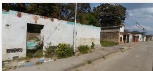
Fotografía 20. Marcas de agua en Paredes evidencia de la inundación, sector Las Flores, año 2023
