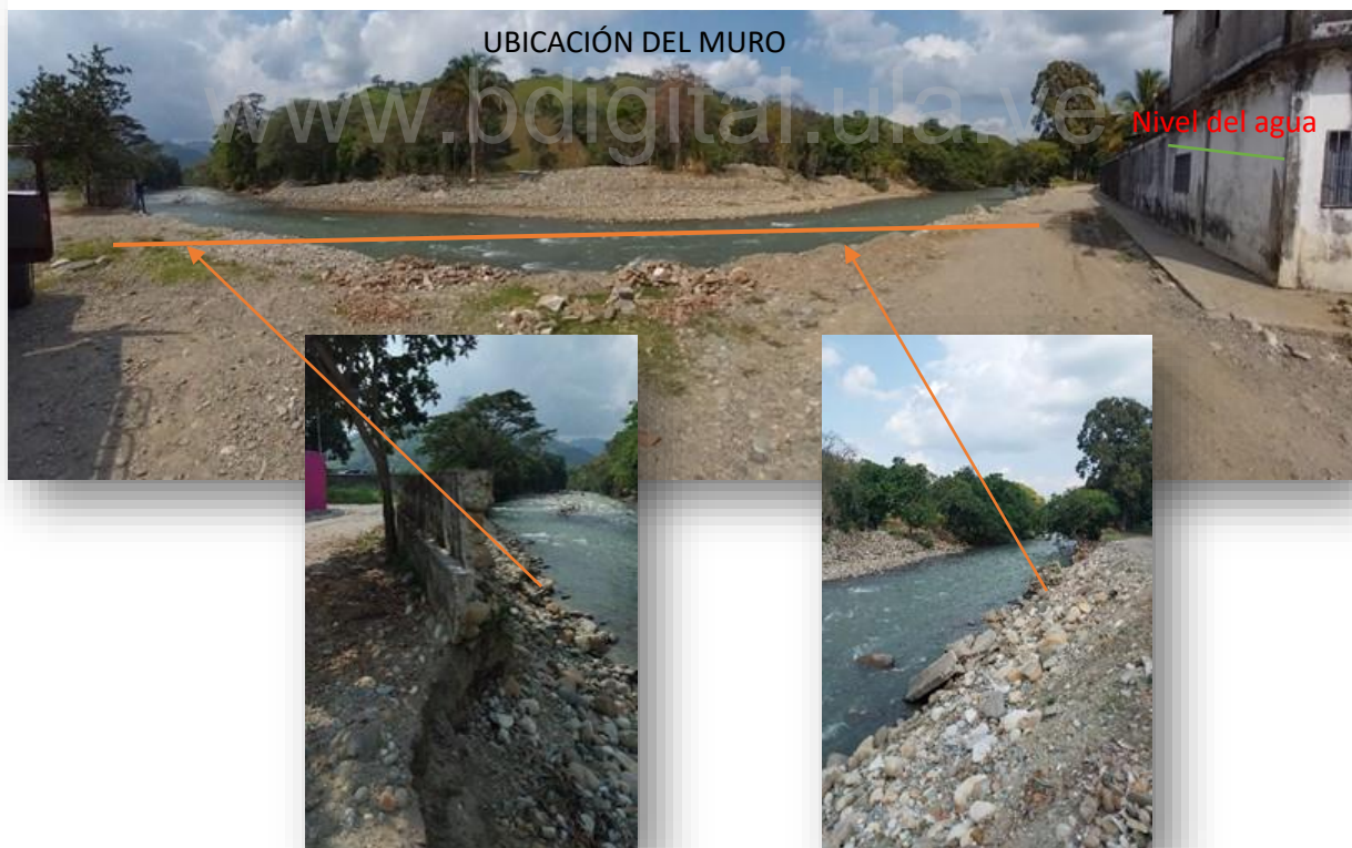
Fotografía 1. Muro de contención afectado, sector Las Flores
