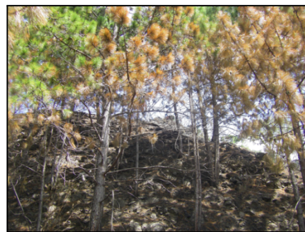
Fotografía 8. Fallamiento de desplazamiento vertical margen izquierdo de la berma.
