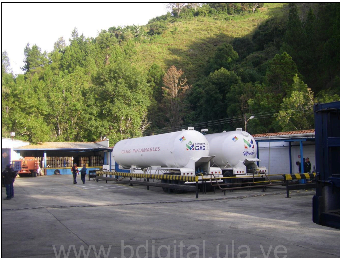
Fotografía 25. Capacidad instalada de almacenamiento del producto GLP en planta "Gral. Jose Justo Briceño Otalora". Tanques de almacenamiento N° 1 y N° 2 con una capacidad efectiva de almacenamiento de 12.897 gal. ó 48, 82 m 3 c/u).
