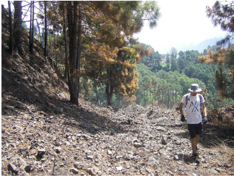
Fig. 12. Berma de acumulación de rocas desprendidas. (Fotografía tomada en diciembre de 2021).
