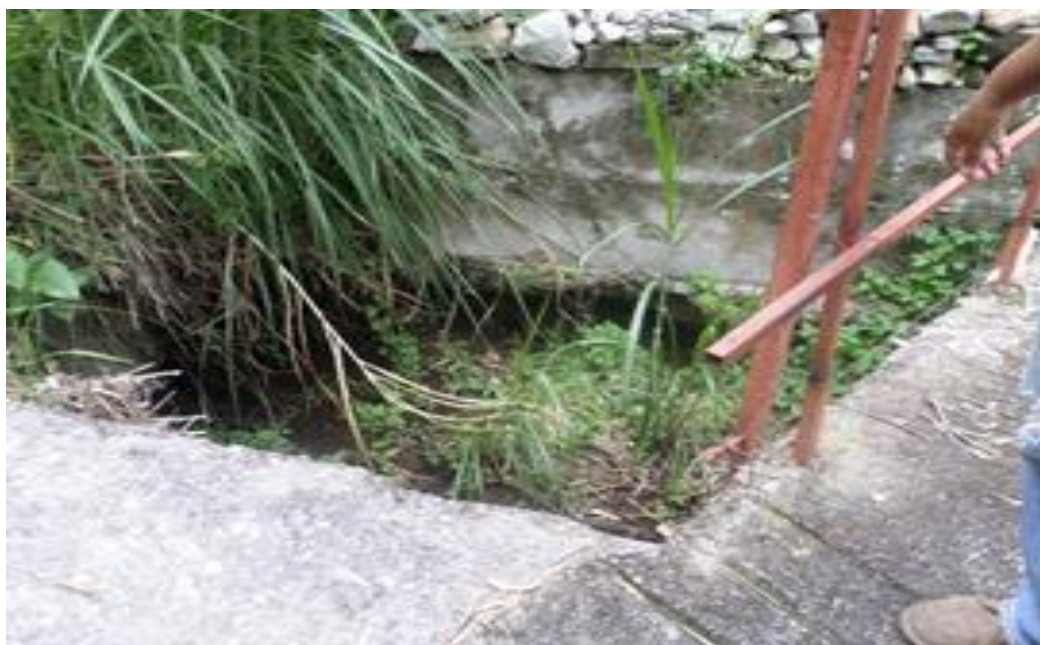
Figura 76. Nótese la presencia de vegetación y la falta de mantenimiento del cauce fluvial. Fuente: Vera, M. (2023).
