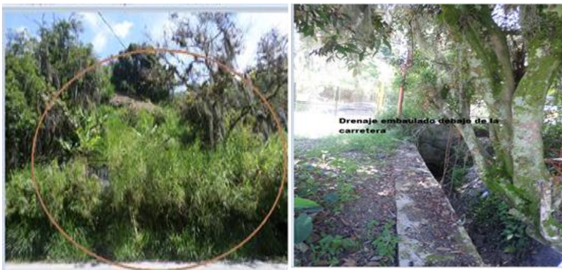
Figura 68. (a) Se muestra obra de control de torrentes cubierto de vegetación (Izq.). Figura 69. (b) Drenaje embaulado debajo de la carretera. (Derecha). Fuente: (Vera, M. 2023).
