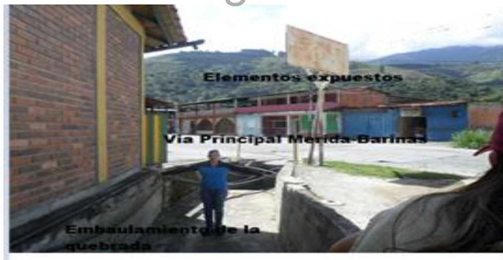
Figura 62. Punto crítico 4. Embaulamiento del cauce con dimensiones no adecuadas. Coordenadas: Este: 268183 m; Norte: 953562m; Altitud: 1562m. Calle Don Eriberto. Fuente: Vera, M. (2023).
