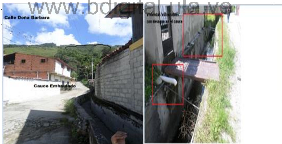
Figuras 63a y 64b. Se observa daños y vulnerabilidad física en la calle Doña Bárbara. Fuente: Vera, M. (2023).
