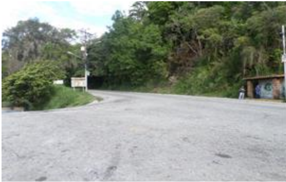
Figura 82. Se detalla la fractura miento de la vía principal. Fuente: Vera, M. (2023).
