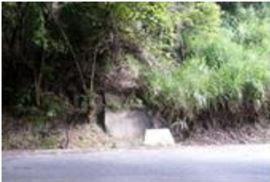
Figura 112. Se muestra muros de contención fracturados. Fuente: Vera, M. (2023).
