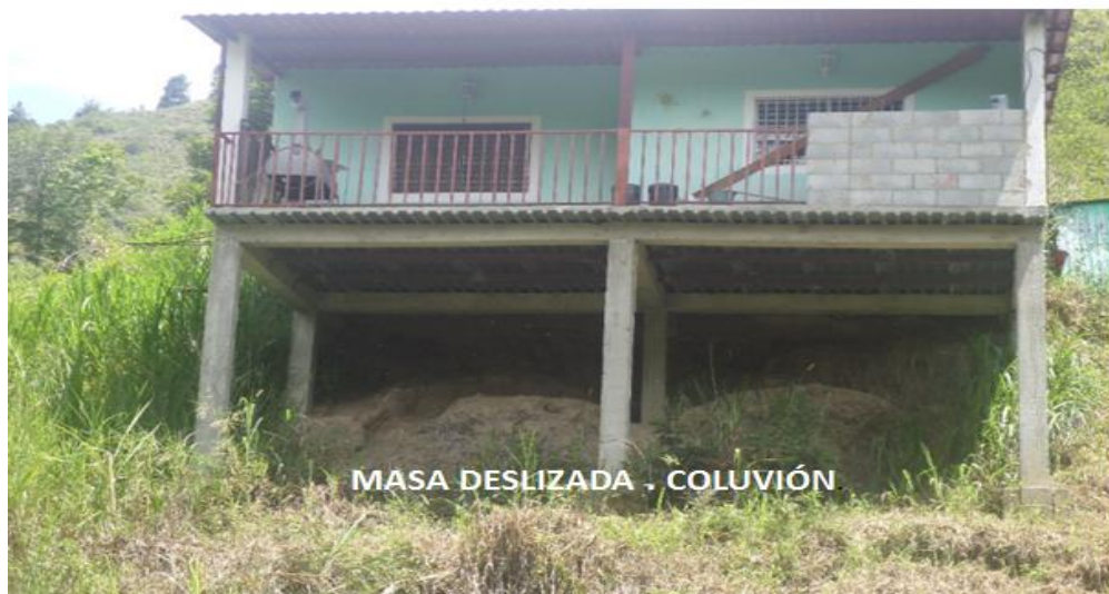
Figura 71. Se observa edificación asentada en masa deslizada. Fuente: Vera, M. (2023).
