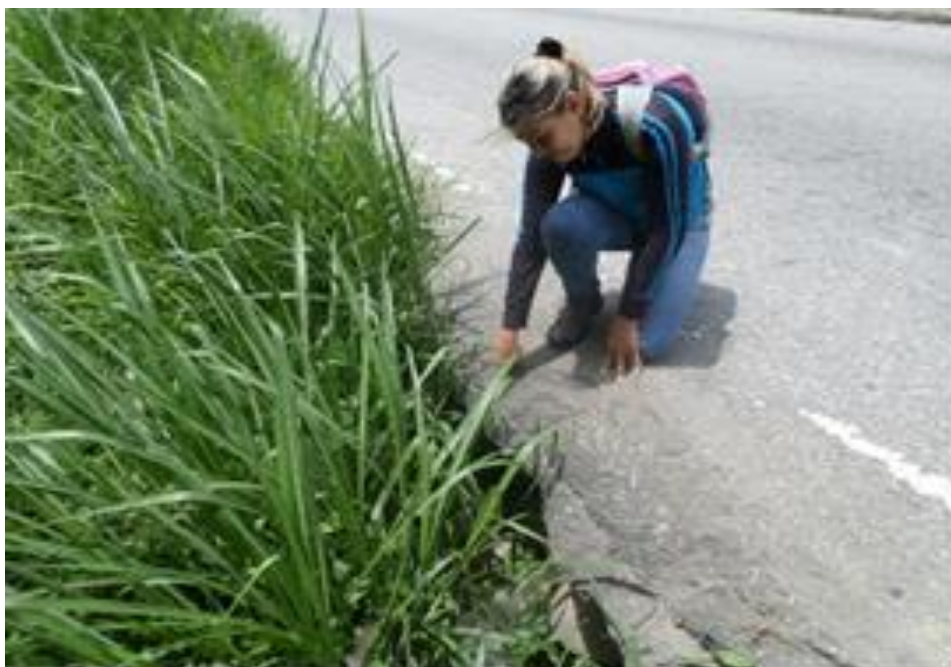
Figura 79. Se observan procesos de erosión que afectan la vialidad. Fuente: Vera, M. (2023).
