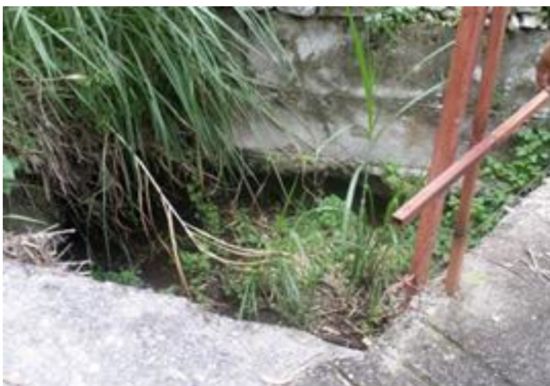
Figura 114. Puentes y canales de esorrentía tapados por vegetación. Fuente: Vera, M. (2023).
