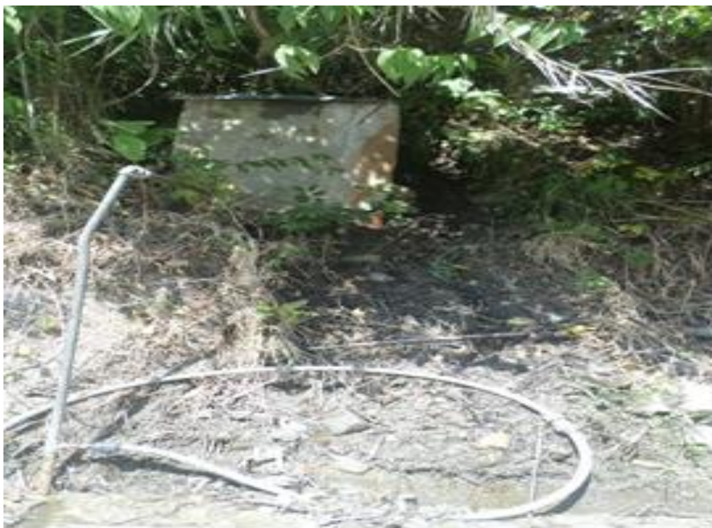
Figura 83. Se muestra el tanque para recepción de agua cuya falta mantenimiento y goteo continuo está saturando los suelos. Fuente: Vera, M. (2023).
