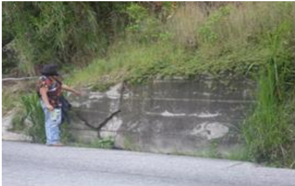
Figura 78. Se muestra el fracturamiento del muro de contención. Fuente: Vera, M. (2023).
