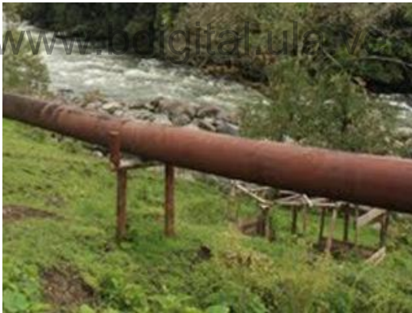
Figura 3-1. Oleoducto en Ecuador. (Fuente: www.rtu.com.ec ).
