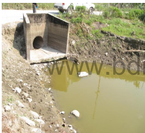
Caja de paso insuficiente
