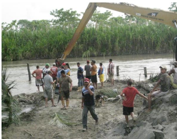
Ruptura del muro marginal río Chama, 2010
