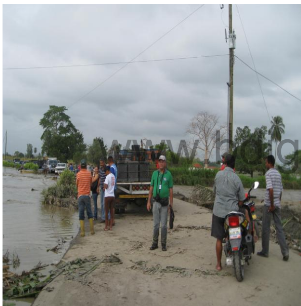
Pérdida vía hacia Caño Muerto, 2011
