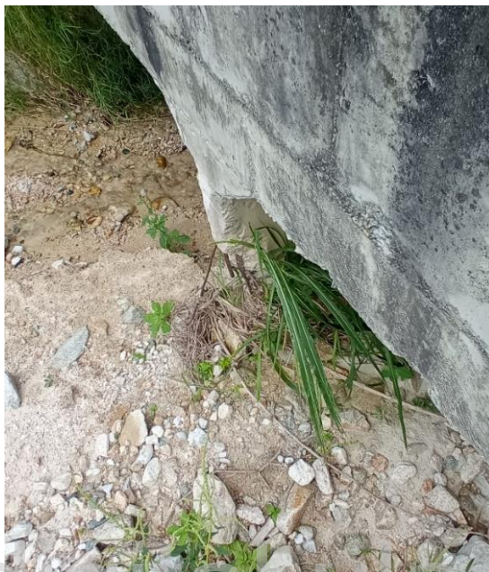
Figura 70. Daños por impacto al pilar central
