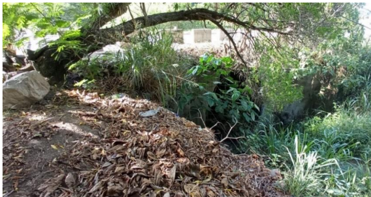
Figura 47. Alcantarilla en la quebrada Carmania/Los Cedros. Presencia de ramas y hojas en el lecho
