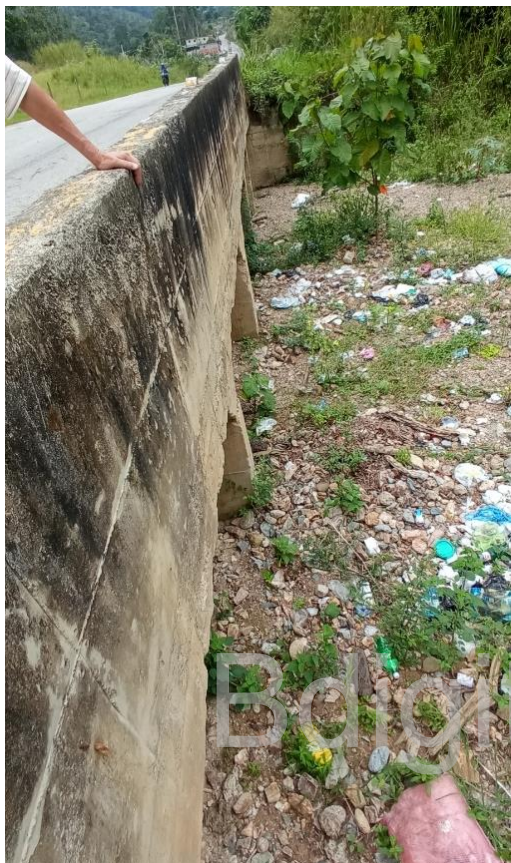
Figura D.1 1. Colmatación mediana de la sección del cajón por depósito de sedimentos y desechos sólidos
