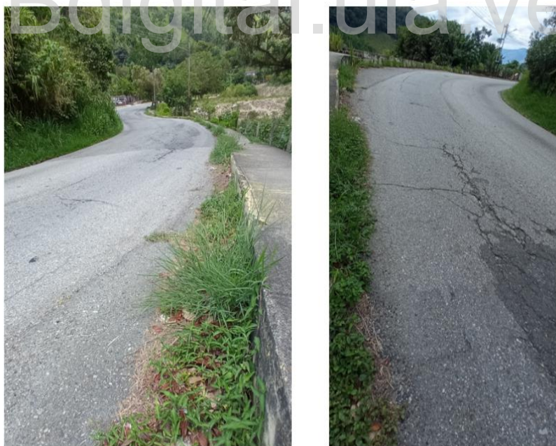
Figura 58. Hundimiento de calzada
