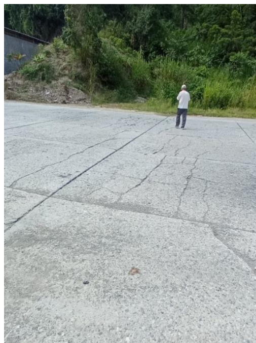
Figura 50. Agrietamiento en el pavimento
