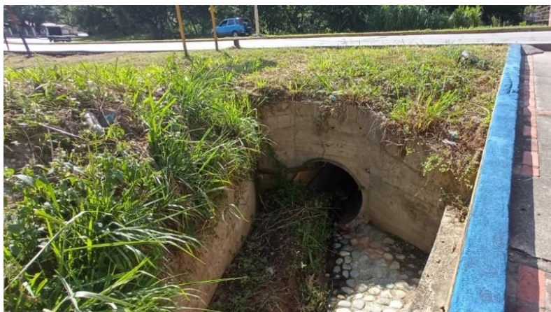
Figura 22. Obstrucción de drenaje transversal
