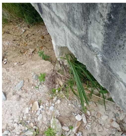
Figura 57. Fractura del muro central con exposición y corrosión del acero de refuerzo
