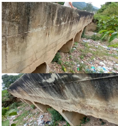
Figura 113. Sedimentos y colmatación aguas arriba y aguas abajo del cajón de paso
