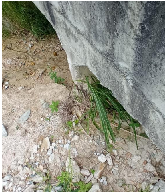
Figura 117. Daños por impacto al pilar central
