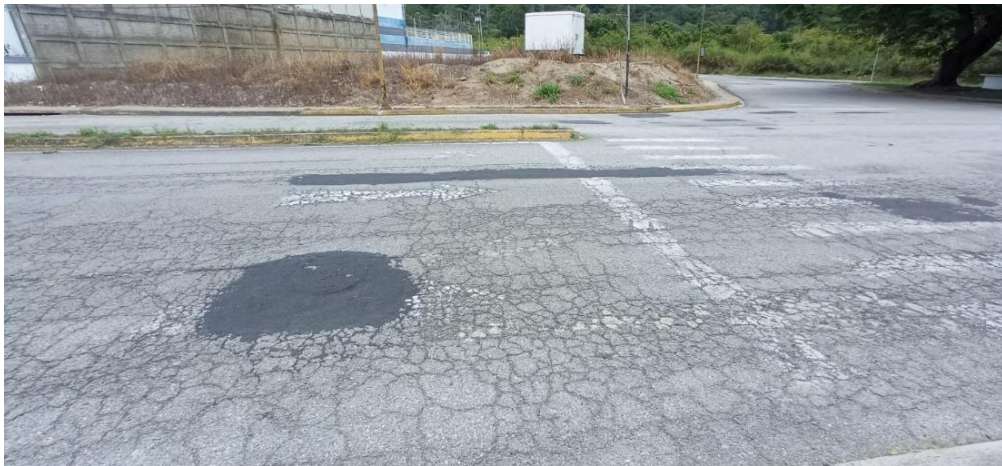
Figura 28. Demarcación horizontal borrosa
