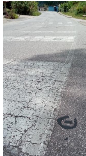
Figura 30. Demarcación horizontal borrosa y pérdida de reflectantes
