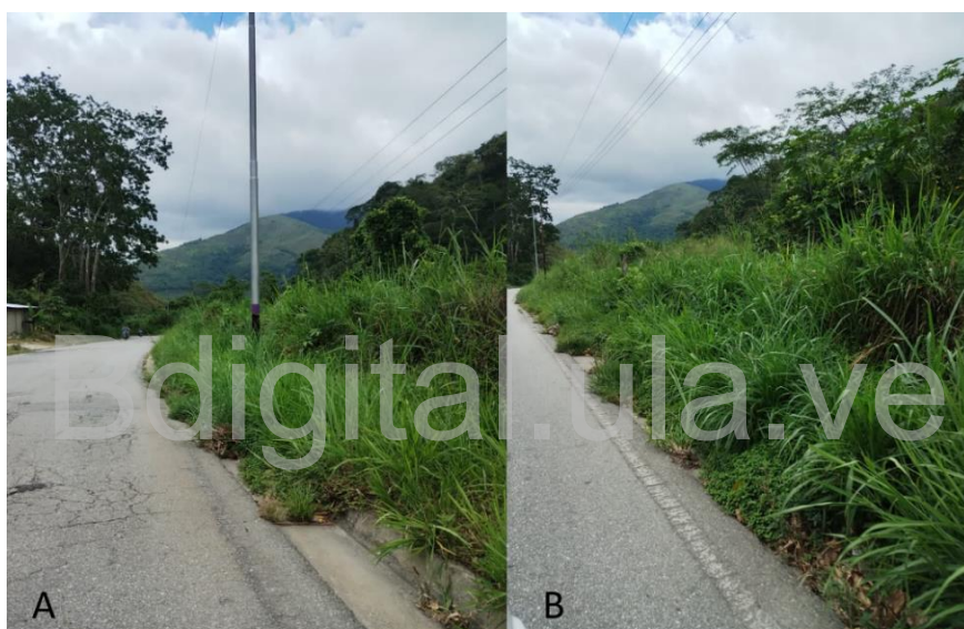
Figura 21. Obstrucción de cunetas
