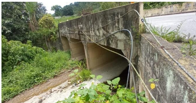
Figura 54. Poca acumulación de material depositado aguas abajo del cajón
