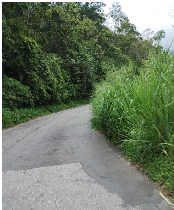
Figura 25. Invasión de vegetación en curva, generando pérdida de visibilidad
