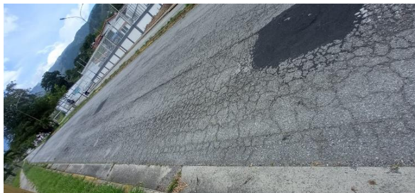
Figura 17. Falla tipo piel de cocodrilo
