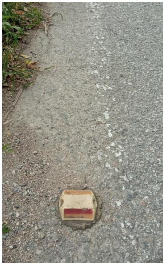
Figura 29. Demarcación horizontal borrosa
