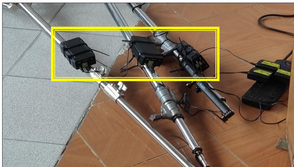
Figura 13 Powers Bank en trípodes metálicos
