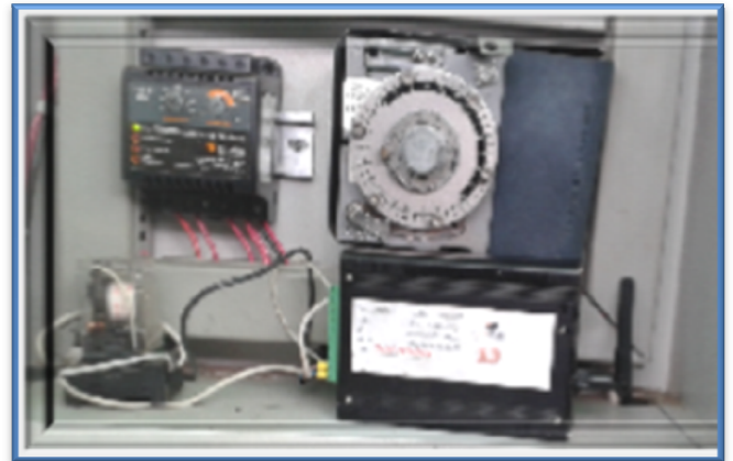
Figura 6: Equipo de apagado automático para las cavas cuarto
