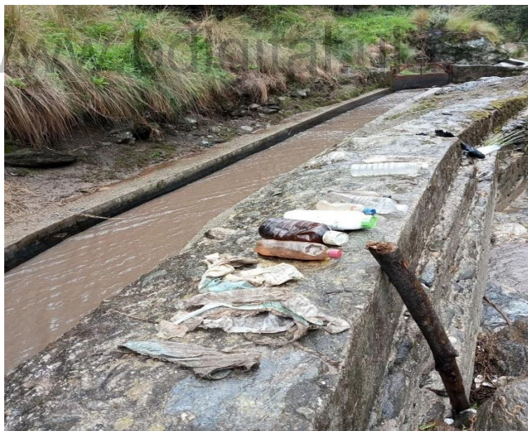
Fotografía 14: Toma de agua de la población de San Lázaro, parroquia Andrés Linares, municipio Trujillo del estado Trujillo. Se observa algunos envases con sustancias tóxicas en su interior durante una limpieza por parte de los ciudadanos
