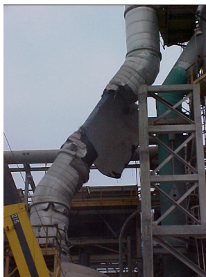
Figura 1: Falla catastrófica en línea de tope de un Regenerador de la FCC [3].
