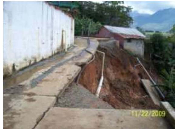
Foto17: derrumbe ocasionado por las fugas
