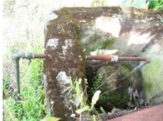
Foto13: Toma ilícita donde se encontraba la ventosa
