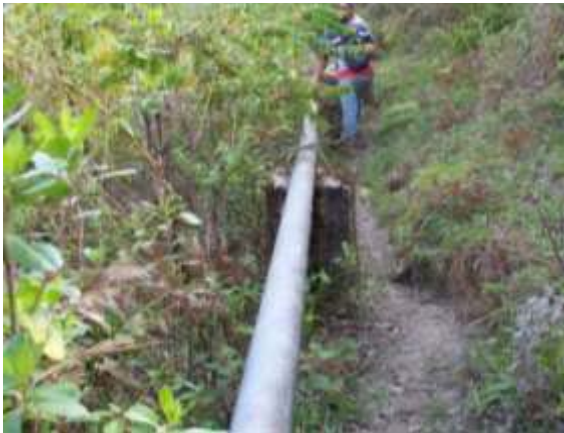
Foto10: Tubería de 3", en buenas condiciones, sobre soportes de concreto.
