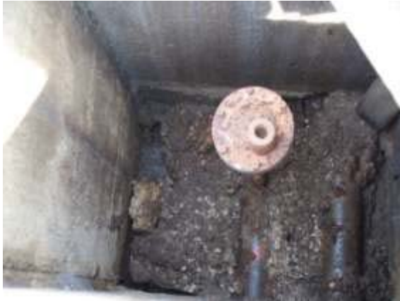
Foto12: Ventosas en malas condiciones
