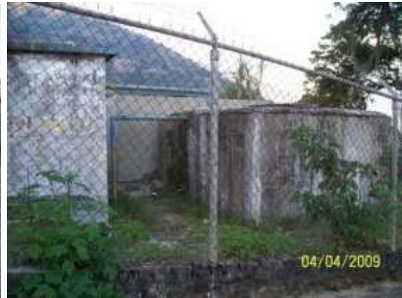
Foto15: Tanque para el rebose.
