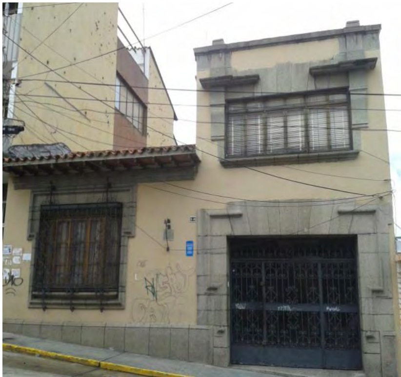
Gráfico N° 3. Casa Gabaldón, frente, lamentablemente deteriorado. Fuente: DA80 (2014)
