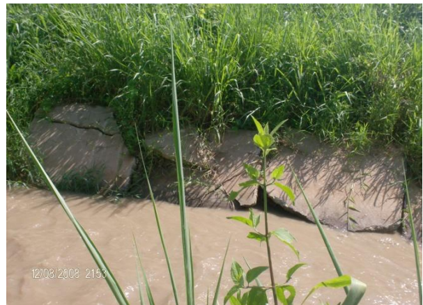
Figura 4.15 Losa fracturada canal principal.
