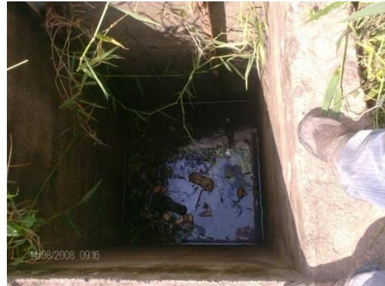
Figura 4.23 Sifón, daños en sus compuertas
