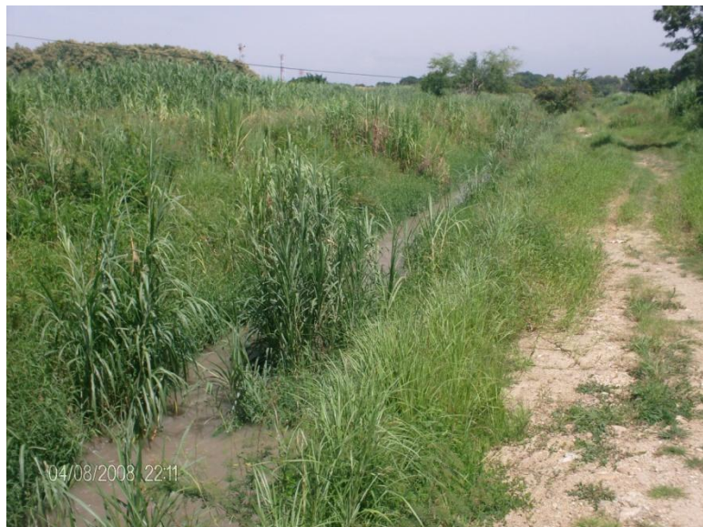
Figura 4.17 Sedimentos, vegetación excesiva en el Canal principal
