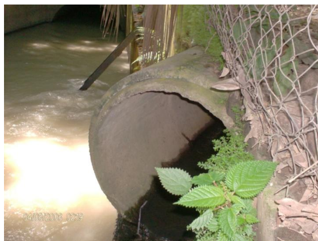
Figura 4.13 Arrojo de aguas contaminadas al canal principal
