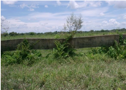
Figura 4.38 Fracturas en hopensas
