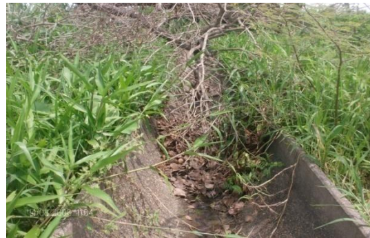
Figura 4.32 Obstrucción de canal elevado
