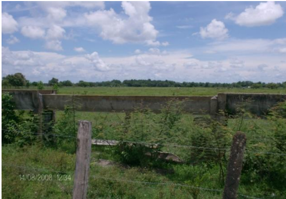
Figura 4.40 Canal sobre puesto
