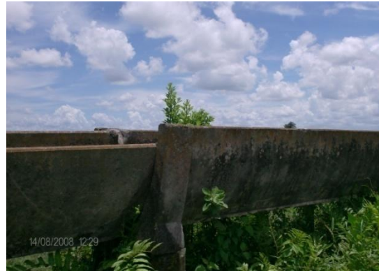
Figura 4.41 Canal sobre puesto
