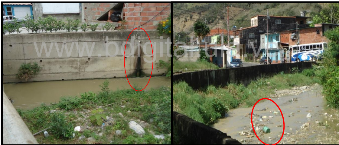
Figura 60. Se observa al lado izquierdo aguas servidas vertidas directamente en el cauce de la quebrada La Zorquera y en el lado derecho plásticos arrojados al cauce producto de la inconsciencia de sus habitantes
