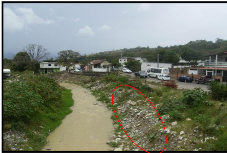
Figura 59. Sedimentos depositados en el cauce de la quebrada La Zorquera en la comunidad de San Isidro
