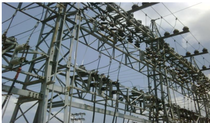
Figura 3.1. Pórtico y barra de transferencia en 13,8 kV de la S/E VIGÍA I
