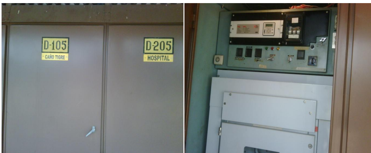
Figuras 4.2 (a) Celda de 13,8 kV (externa) S/E VIGIA I
